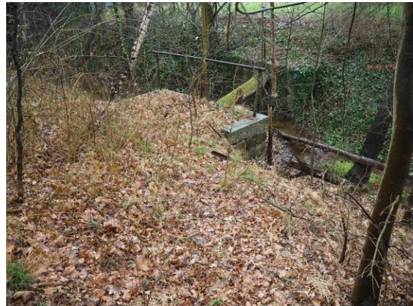
Abb. 8: Entengraben westlich der EÜ, mit querender Leitung
